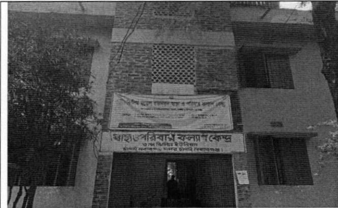
ভবন পুরাতন ও ছাদের অবস্থা জরাজীর্ণ
